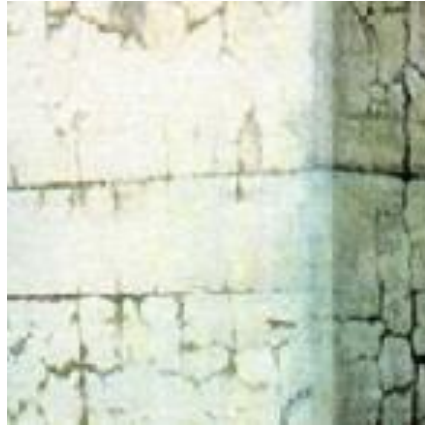
Повреждения от солей и мороза
